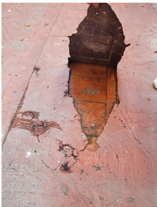
Foto N° 01: roturas y levantamiento en membrana
