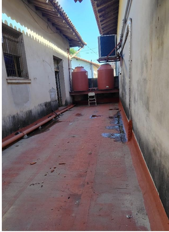
Foto N° 02: acumulación y permanencia de agua en cubierta por falta de escurrimiento.
