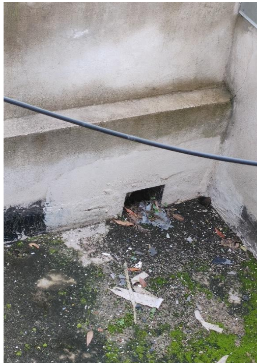
Foto N° 03: falta de rejilla en pluvial
